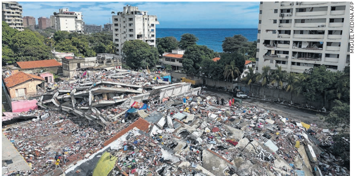
Vue aérienne de bâtiments effondrés à Caraballeda, dans l'État de La Guaira, le 30 juin.
